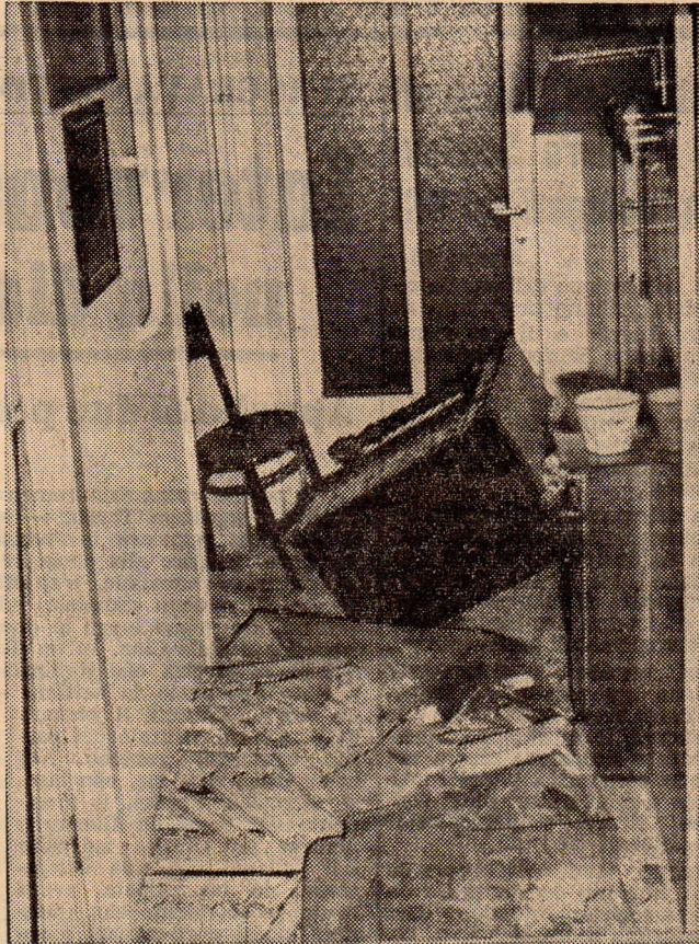
Il pavimento sollevato e sbracciato dallo scoppio nell'abitazione soprastante quella in cui è avvenuta l'esplosione del gas
